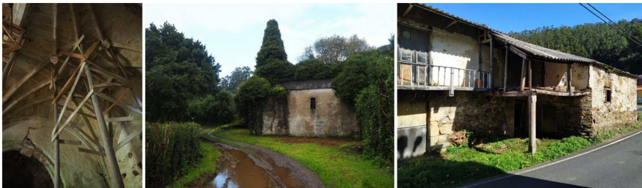
Construcións con graves problemas de deterioro. Igrexa de San Pedro de Loira (esquerda e centro) e casa da Bastona (dereita).
